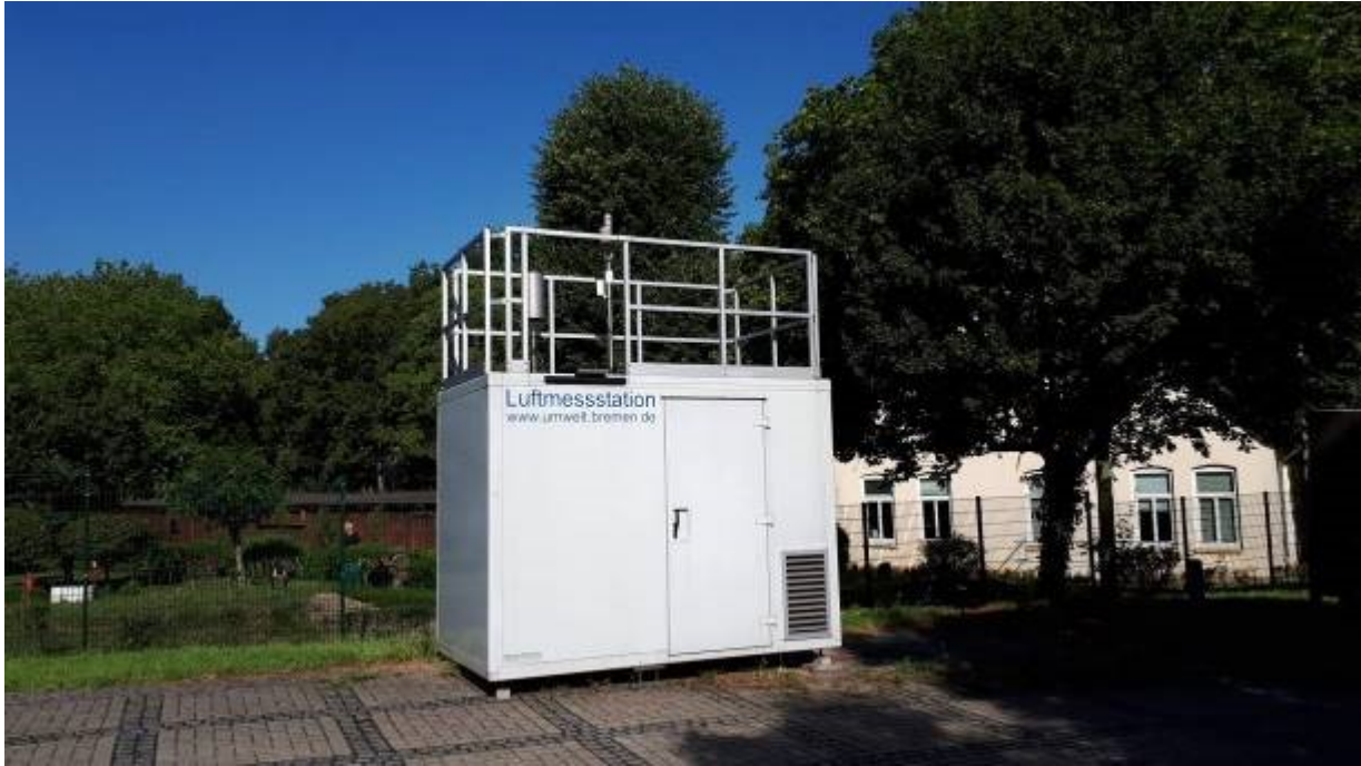
Foto: Luftmessstation Oslebshausen
